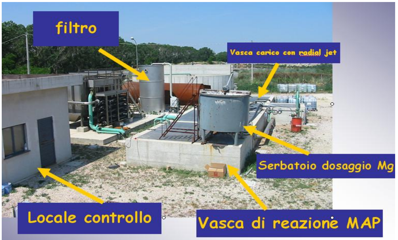
Fig. 1–Visión de conjunto instalación SERMAP® (Bettona, Perugia, 300 m 3 /die)
