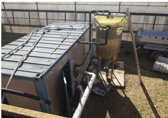
Fig. 1. Impianto pilota di deammonificazione con precipitazione della struvite organica.
